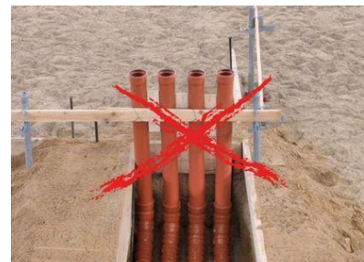
Nicht zulässige KG-Rohre
